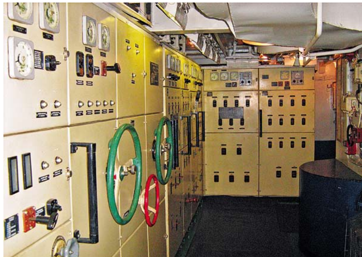
Большой морской сухогрузный транспорт «Яуза». Центральный пост управления. Пр. 550
